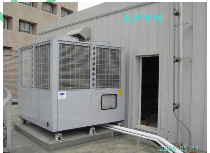
氣冷式冰水主機
