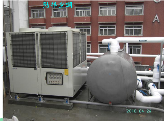
氣冷式冰水主機+儲冷水桶+變頻冰水泵
