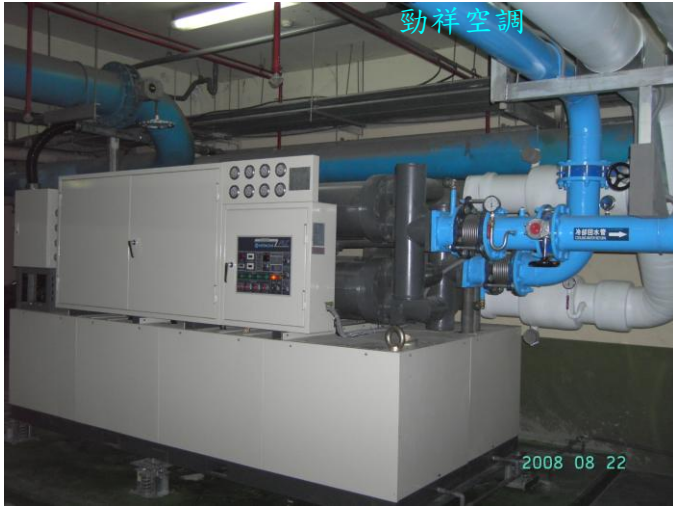
日立水冷螺旋式冰水主機 (240RT)
