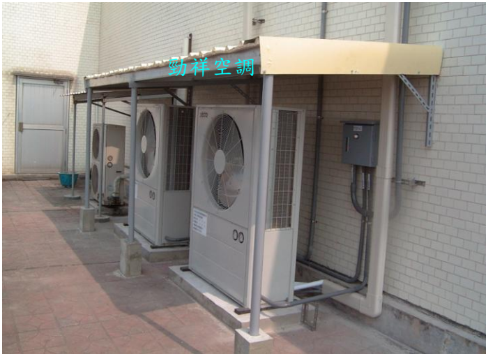
氣冷分離式室外機+修飾管槽
