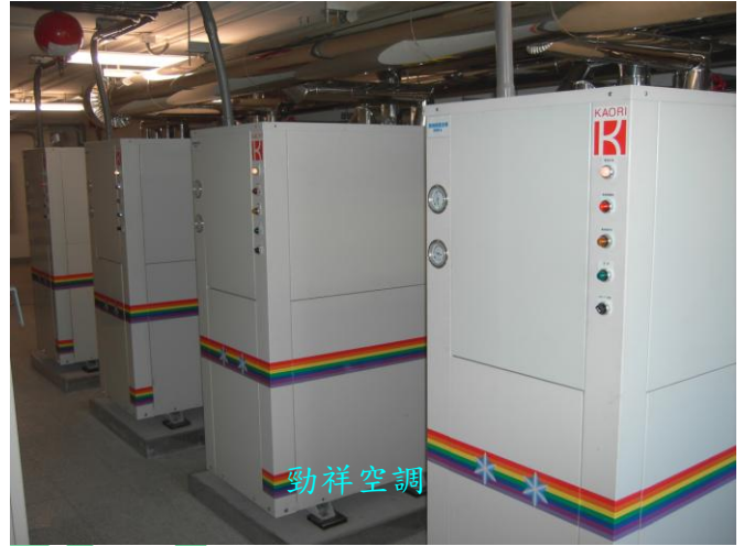
水對水熱泵主機
