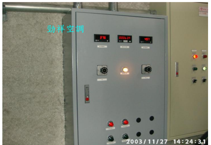
配電盤數位錶(V KWH A)
