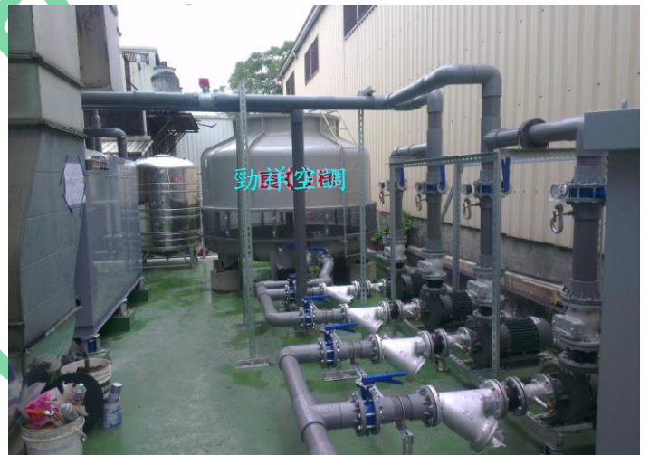
冰水主機+冰水泵+冷卻水泵+儲冷水桶+冷卻水塔
