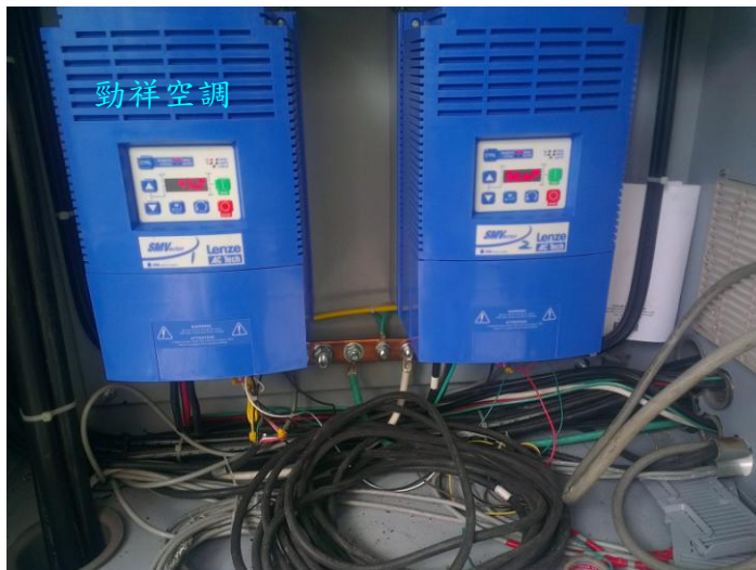
變頻器(水泵用)
