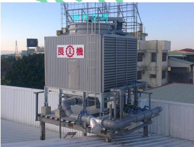
方型直交流式冷卻水塔+冷卻水泵
