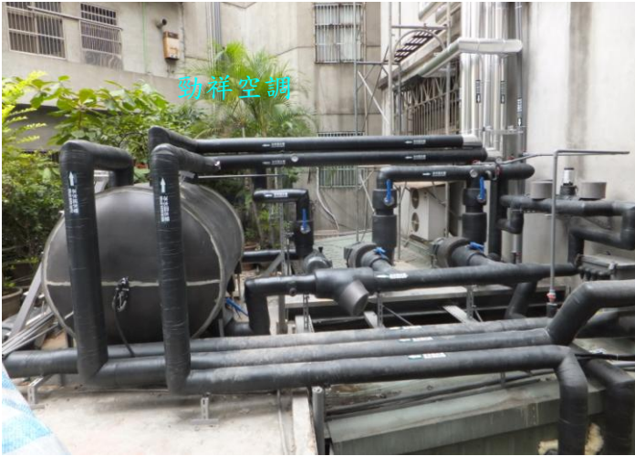
變頻冰水泵+儲冷水桶
