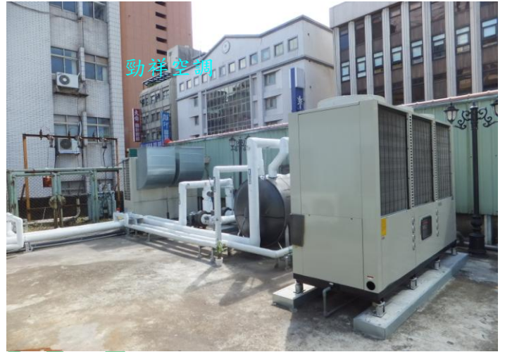
冰水主機+變頻冰水泵+儲冷水桶
