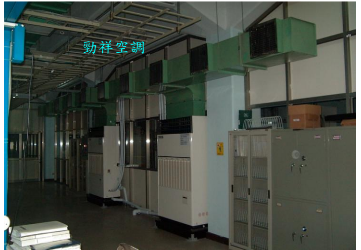
氣冷分離式室內機+風管
