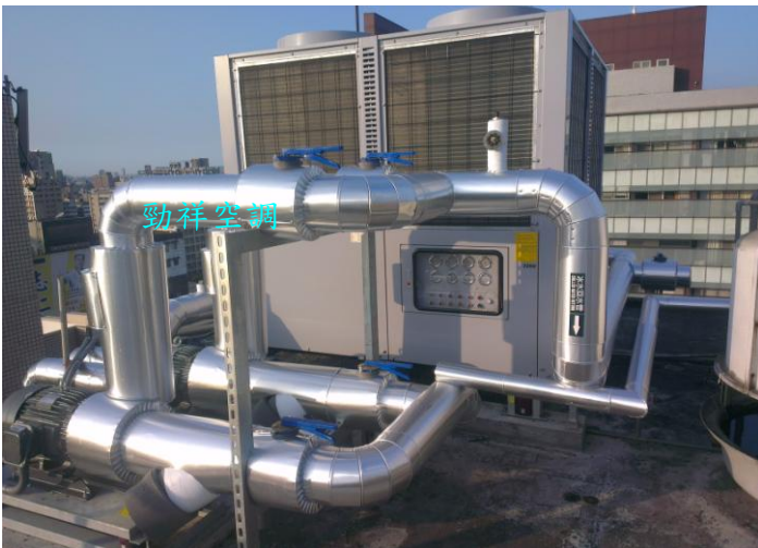
冰水主機+變頻冰水泵+鋁皮保溫
