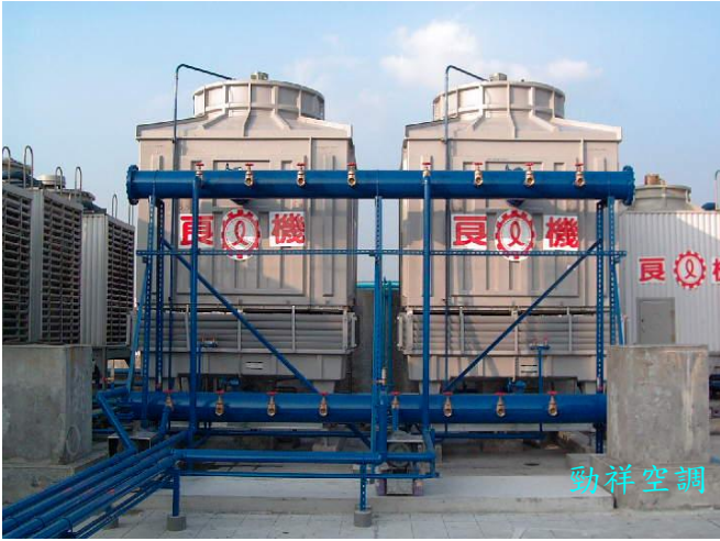
方型逆流式冷卻水塔
