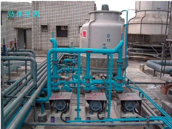
圓型冷卻水塔+冷卻水泵
