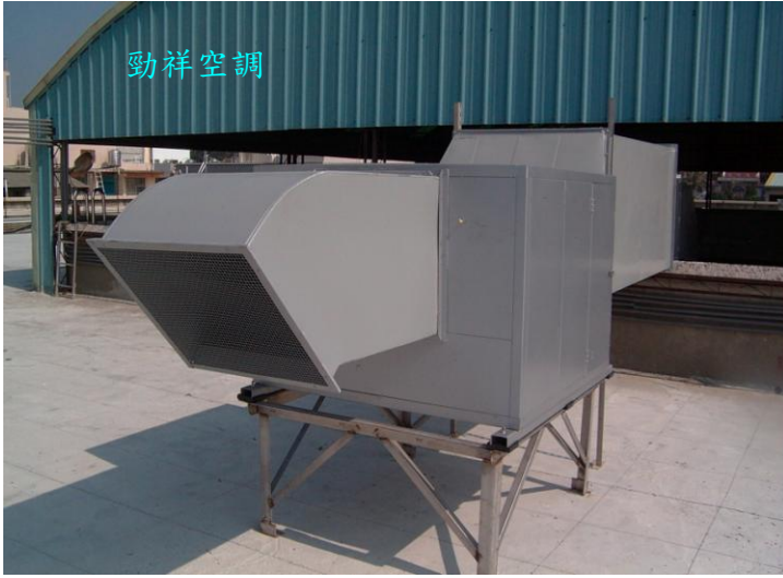
排風機+消音箱+不銹鋼安裝架
