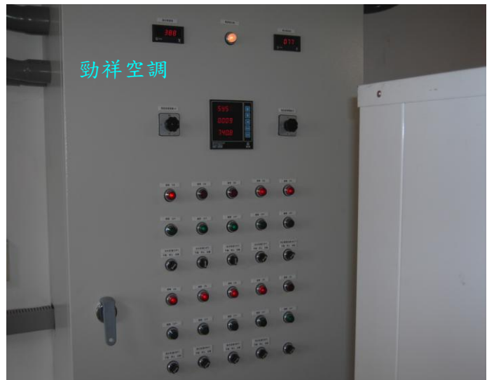
配電盤數位錶(V 多功能電錶 A)
