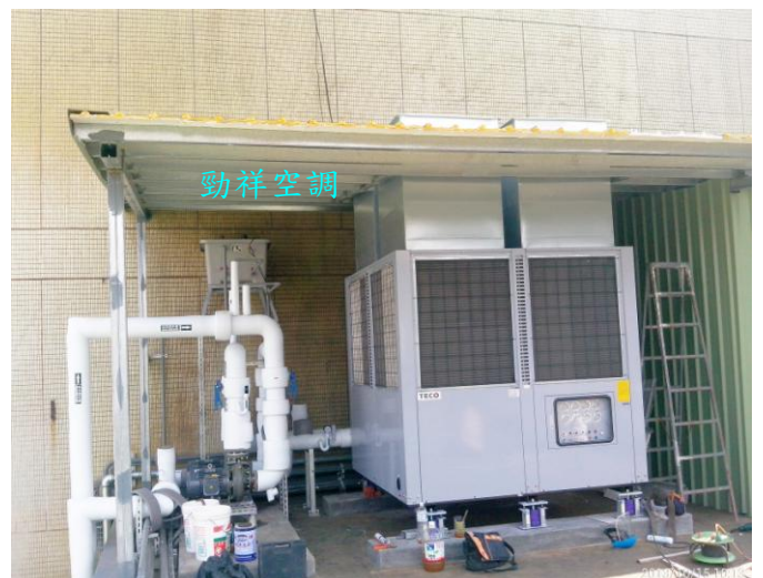
氣冷式冰水主機+變頻冰水泵+膨脹水箱
