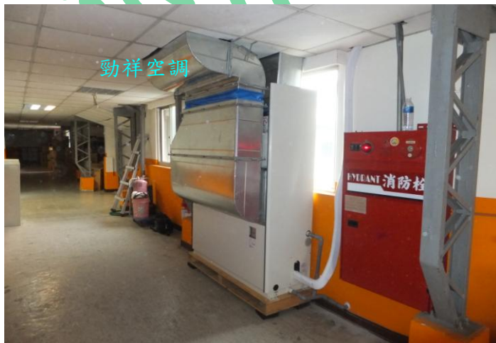
氣冷箱型機進回風管
