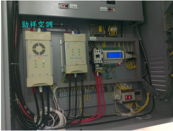
恆溫恆濕控制(SCR+DDC)
