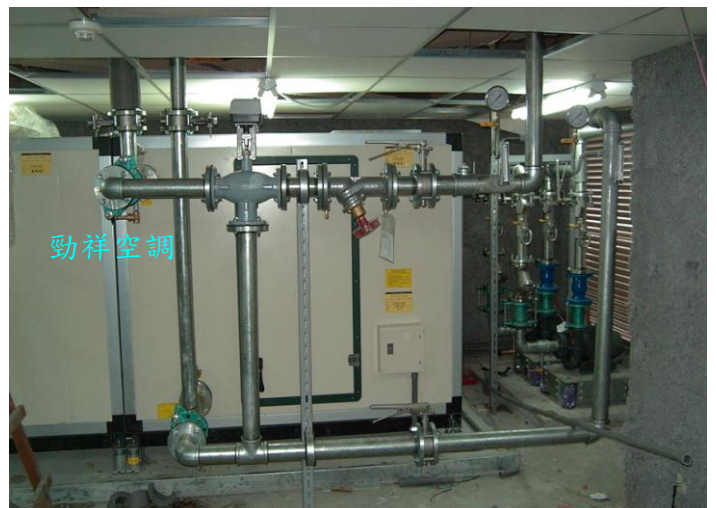
室內空調箱+冰水泵
