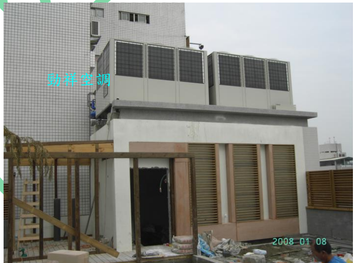
氣冷冰水主機 (80RT*2)
